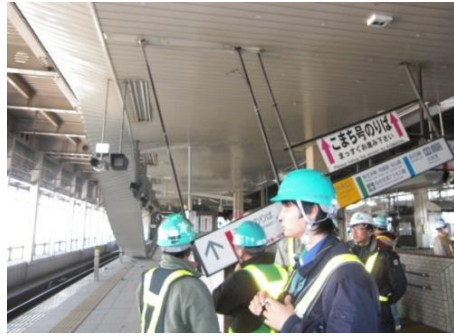
仙台駅被災状況
