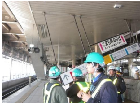
仙台駅被災状況
